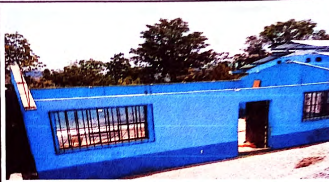
Foto 2: aula 2 ya destechado con láminas y costaneras de madera en mal estado.
